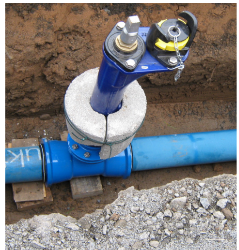
Hydrant unterirdisch zur Wasserentnahme mit Sickerstein.
